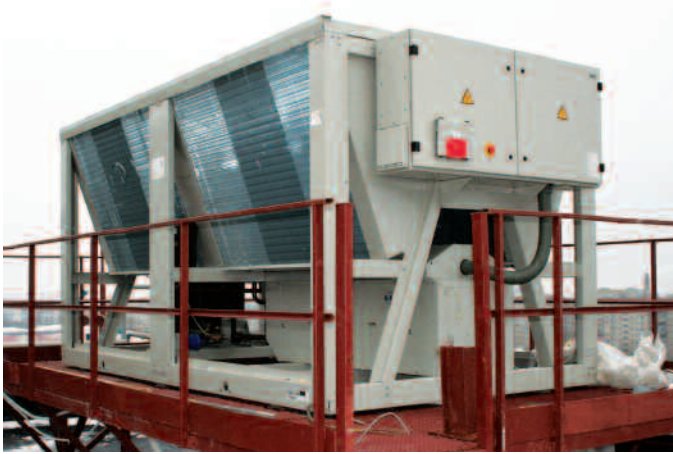
Моноблочний чилер повітряного охолодження конденсатора зовнішнього встановлення на ГФВ
